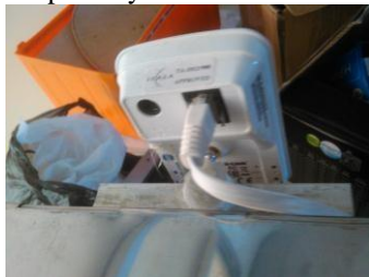
Gambar 13 Kabel UTP tersambung dengan Kamera
