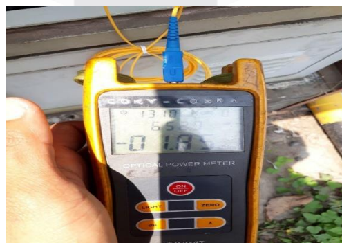
Gambar 4.1 Pengukuran Core feeder pada ODC sesuai optimasi perancangan
