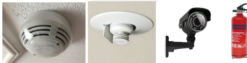
Gambar 6 Smoke Detector, Sprinkler, CCTV, dan Tabung Pemadam Kebakaran
