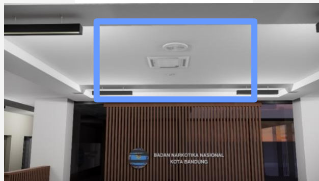
Gambar 4.14 Penggunaan AC Casette Pada Ruang Pelayanan.
