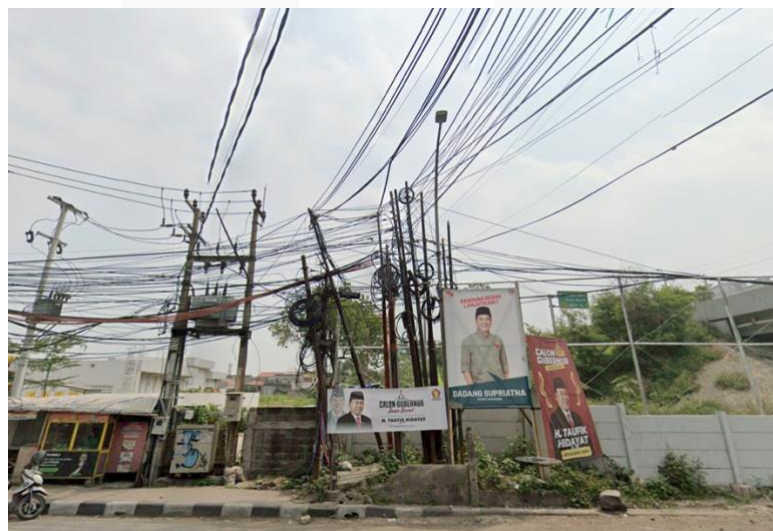
Gambar 1.2 Kabel Semrawut Sumber: Dokumentasi Penulis
