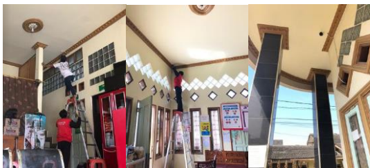
Gambar 4. Titik Pemasangan CCTV
