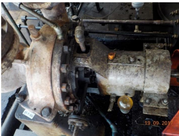
GAMBAR 2 (Mesin Pompa 06 CDU-3)
