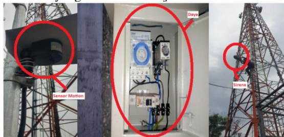
Gambar 1. Sistem Surveillance Yang Sebelumnya Sudah Terpasang
