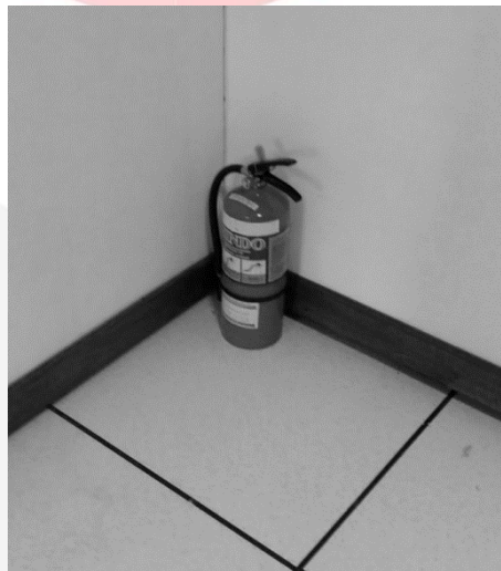
Gambar 13 APAR di dalam ruangan data center
