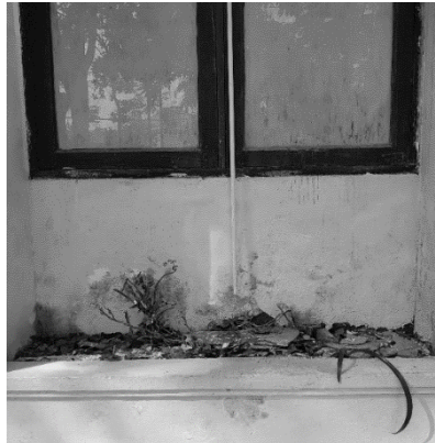
Gambar 9 Dinding di luar data center
