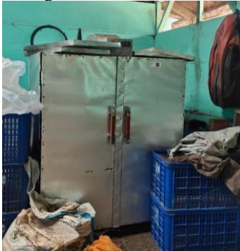
GAMBAR 2 Kondisi Mesin Eksisting
